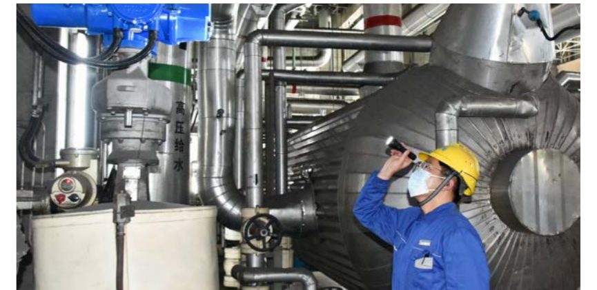
川南发电公司发电部巡检员在巡视中查看电动门设备的运行状态
